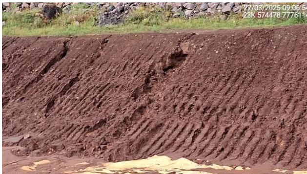
Foto 6.61 – Processo erosivo no talude escavado na margem esquerda.
