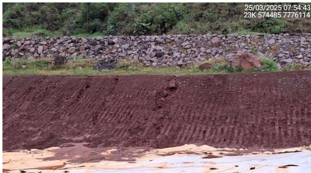
Foto 6.60 – Processo erosivo no talude escavado na margem esquerda.
