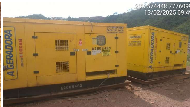
Foto 6.68 – Geradores de alimentação do sistema de bombeamento do sump .
