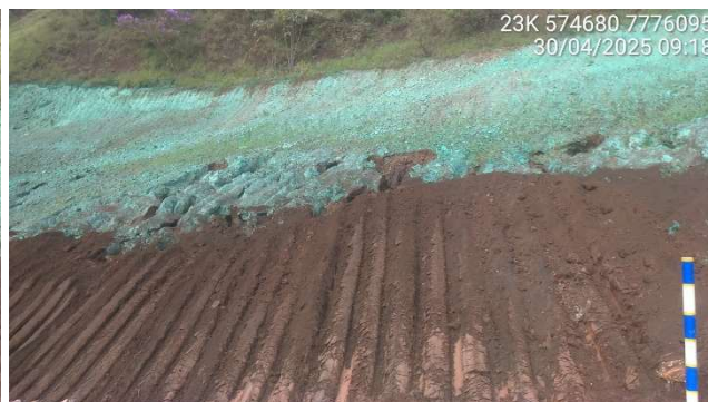
Foto 6.65 – Processo erosivo na região da encosta próxima ao sump do reservatório.
