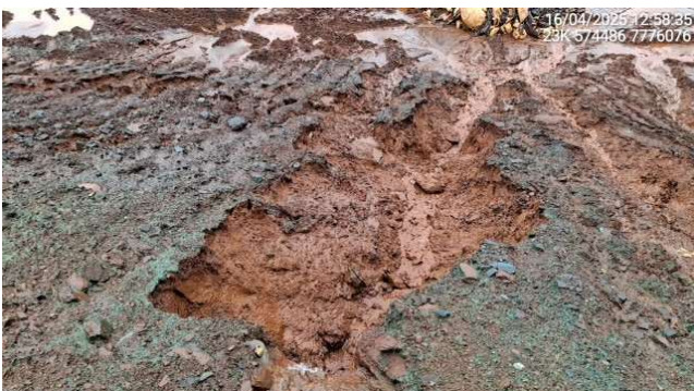
Foto 6.62 – Processo erosivo no talude escavado na margem esquerda.
