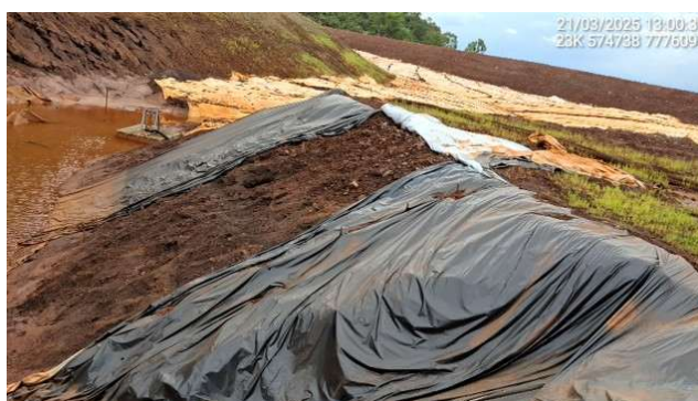
Foto 6.59 – Falha no revestimento de proteção na face do talude do sump .
