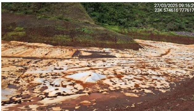
Foto 6.58 – Falha no revestimento em PEBD do reservatório.
