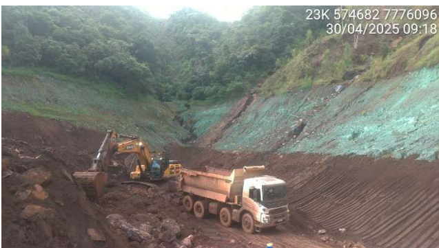
Foto 6.64 – Processo erosivo na região da encosta próxima ao sump do reservatório.
