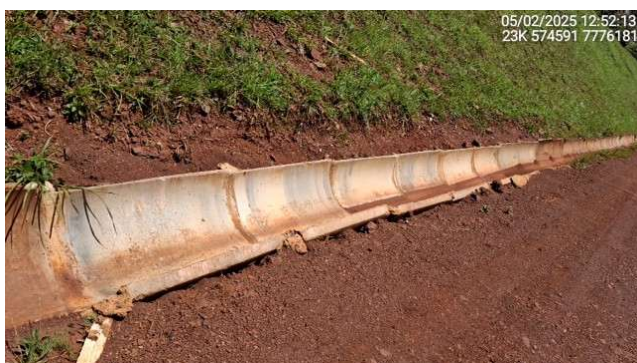
Foto 6.51 – Dispositivo de drenagem superficial da berma elev. 1.119,0 descalçado.
