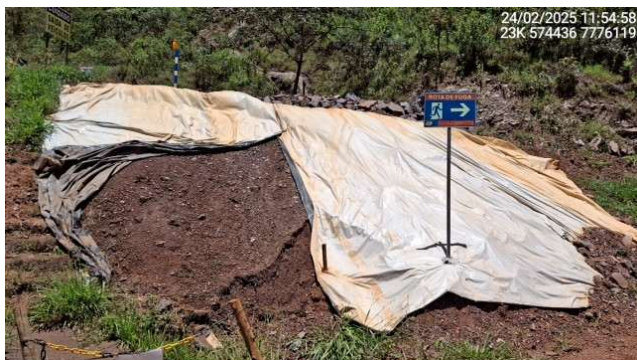
Foto 6.53 – Falha no transpasse na proteção da erosão no talude do acesso à crista da estrutura.
