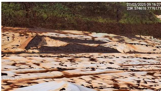
Foto 6.57 – Falha no revestimento em PEBD do reservatório.
