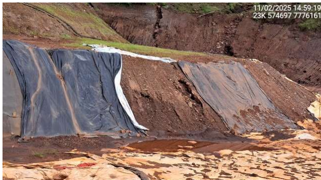
Foto 6.49 – Falha no revestimento de proteção da erosão na face do talude de montante.
