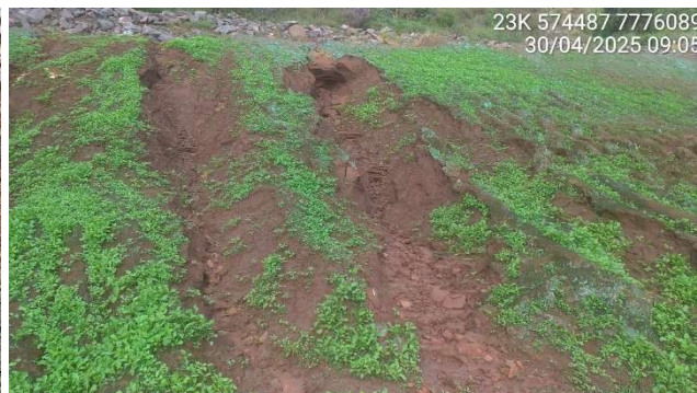
Foto 6.63 – Processo erosivo no talude escavado na margem esquerda.
