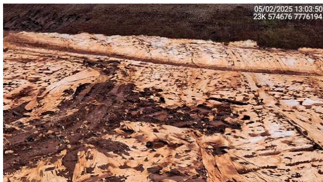
Foto 6.47 – Revestimento do reservatório danificado devido ao tráfego de equipamentos.
