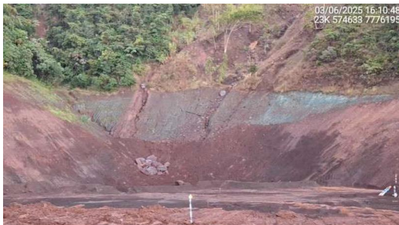
Foto 6-44 - Processo erosivo na região da encosta próxima ao sump do reservatório.
