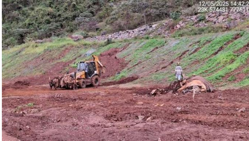
Foto 6-45 - Restos de revestimento em PEBD acumulados dentro do reservatório.
