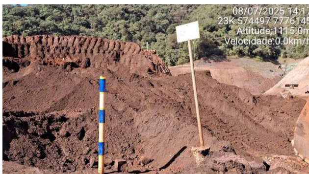
Foto 6-35 - Rebaixamento do instrumento INA-19.
