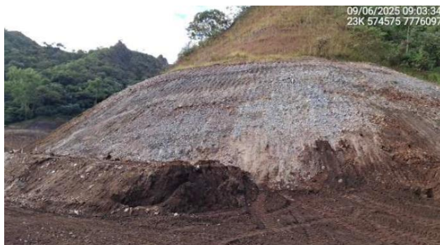
Foto 6-15 - Remoção do rejeito na encosta à montante do reservatório.
