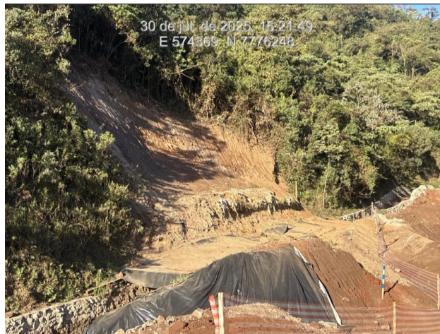
Foto 5-9 - Situação atual pós retirada do material solto na encosta O.D.
