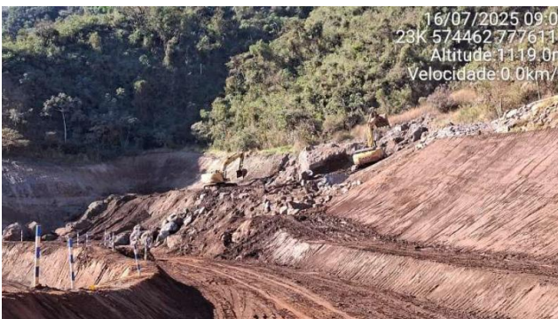
Foto 6-40 - Cominuição de blocos na encosta natural próxima à margem esquerda.
