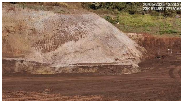
Foto 6-16 - Remoção do rejeito na encosta à montante do reservatório.
