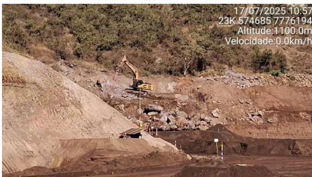
Foto 6-39 - Cominuição de blocos na encosta natural próxima à margem esquerda.
