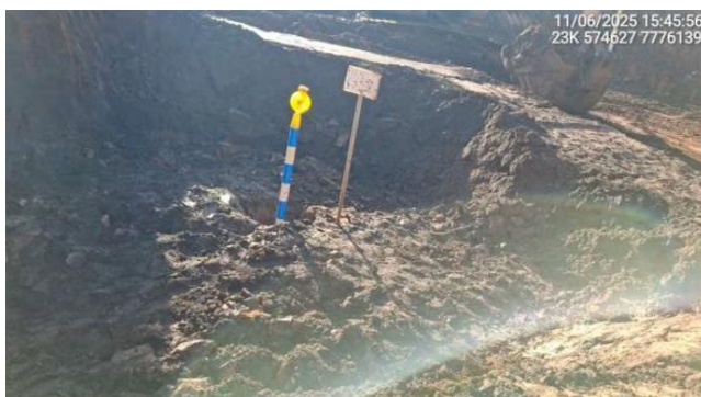
Foto 6-21 - Rebaixamento do instrumento INA-33.
