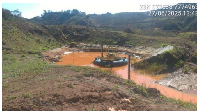
Foto 5-5 – Sistema de bombeamento localizado na baia intermediária.
