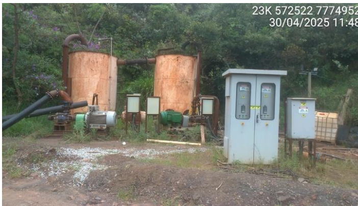
Foto 5-2 – Vista dos tanques e bomba BA13.
