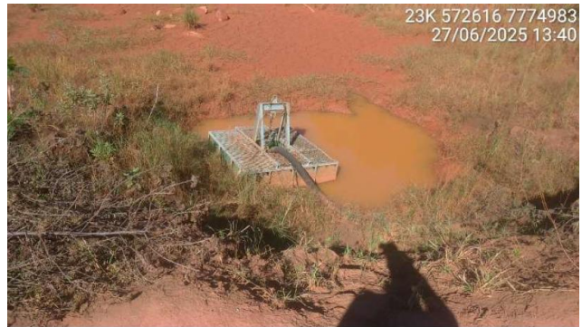
Foto 5-7 – Sistema de bombeamento localizado na baía de montante.
