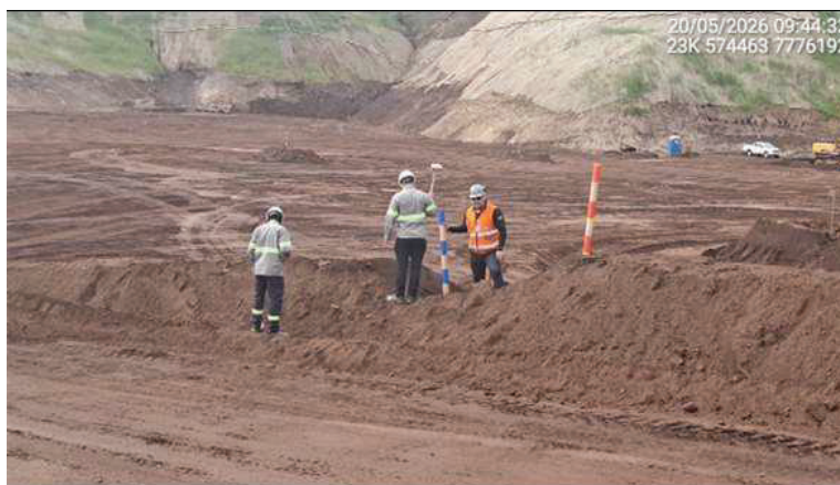
Foto 6.36 - Rebaixamento da cota do instrumento INA-36 (Maio/26).
